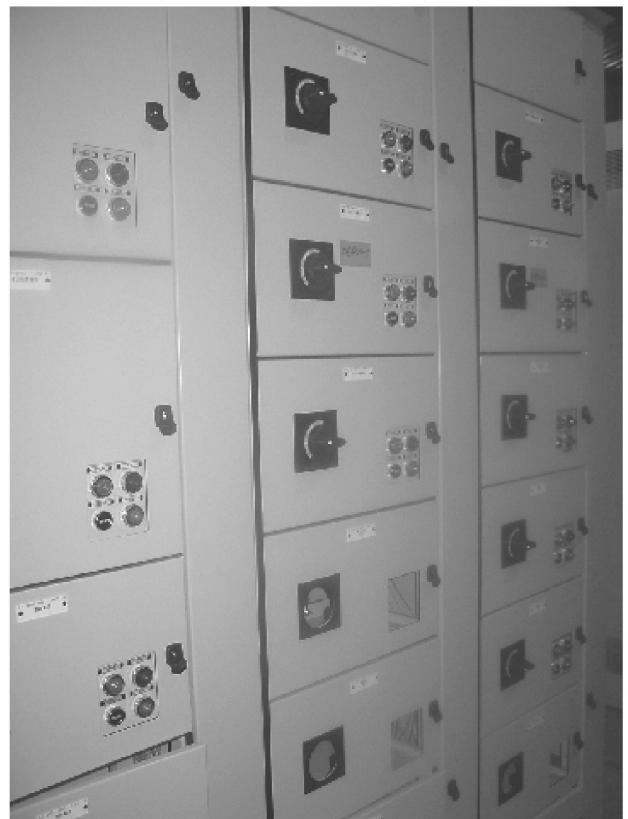
圖3 RESET 線控模組安裝於MCC盤
